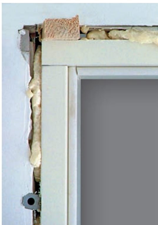
Esempio di errato raccordo della cassaporta alla muratura, che può comportare una perdita di potere fonoisolante di anche 8 dB.
